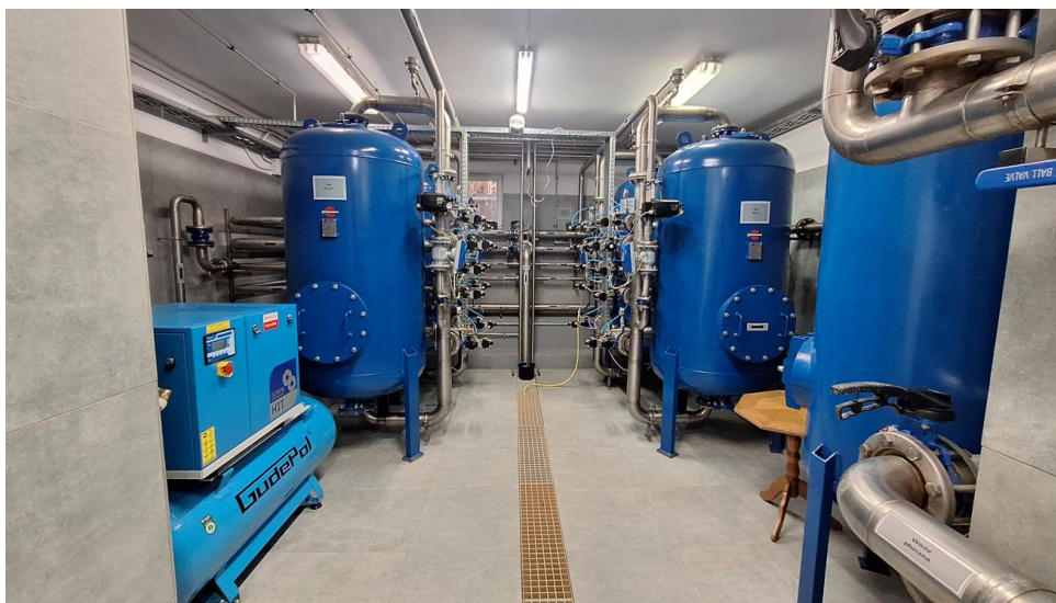
Fot. Wnętrze Stacji Uzdatniania Wody po modernizacji (źródło: Gospodarka Komunalna sp. z o.o. w Boguchwale)
